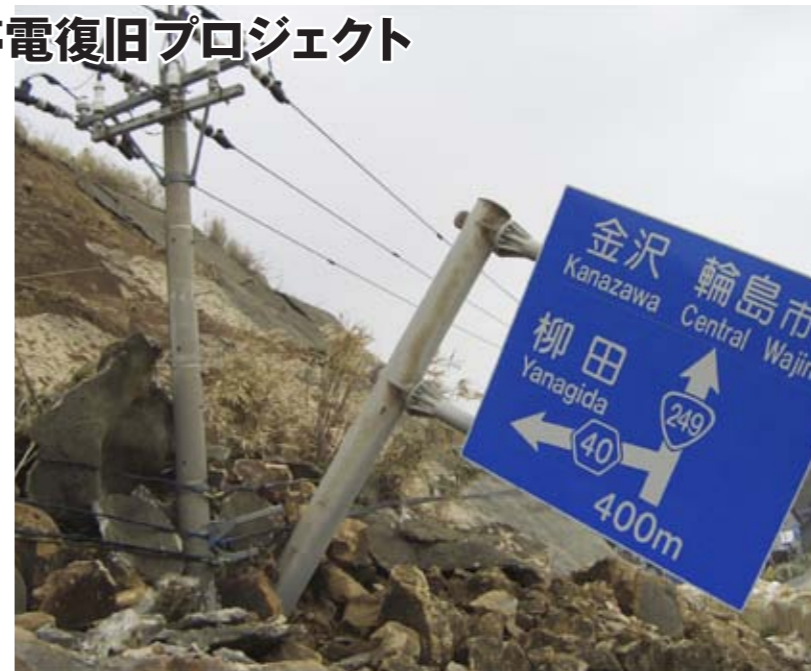
能登半島地震によって被災した配電設備
