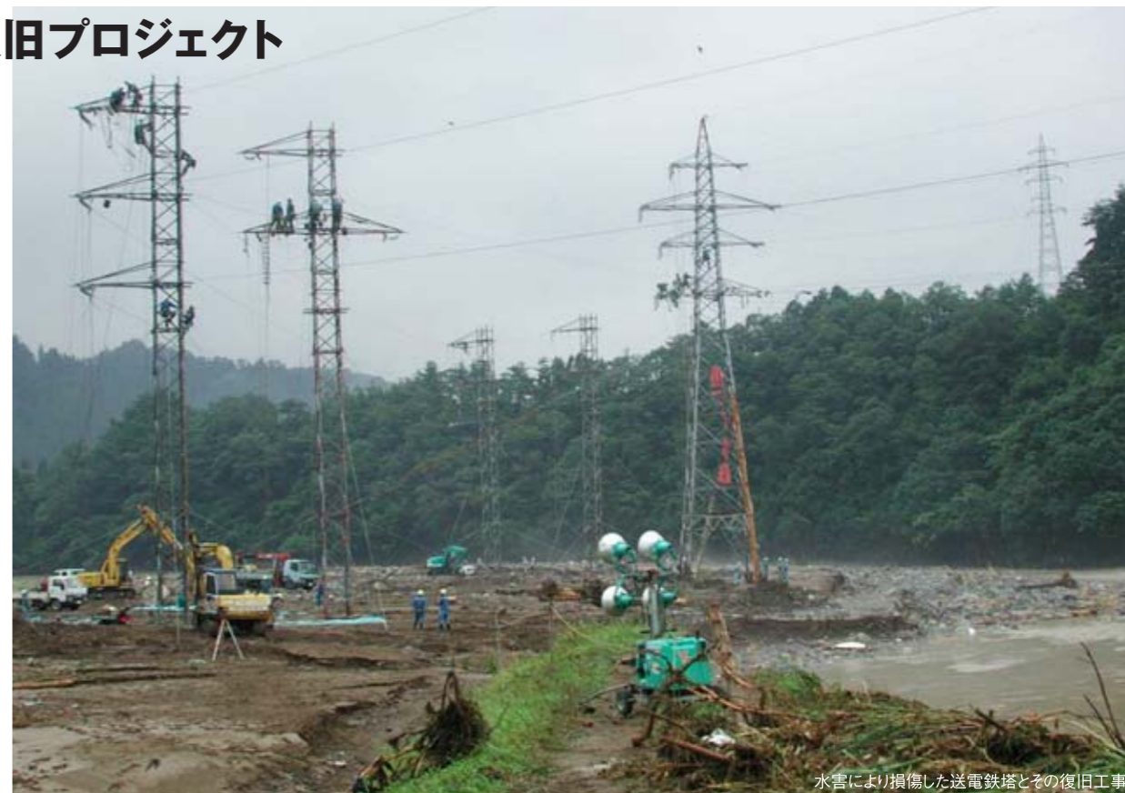
水害により損傷した送電鉄塔とその復旧工事
